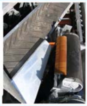
Узел привода конвейера
